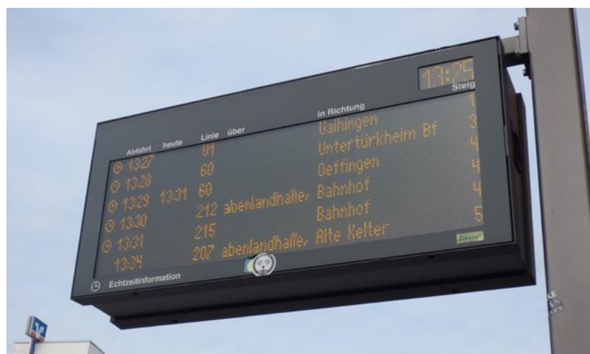
DFI-Anzeige Lutherkirche (LED-Technik)
